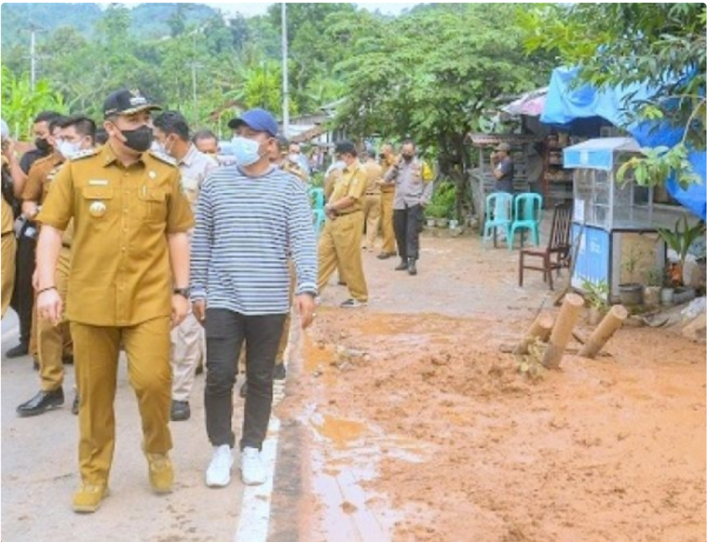
Bupati Pesawaran Dendi Ramadhona meninjau lokasi proyek galian tanah yang menyebabkan banjir lumpur
